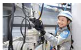
福 配電テクニカルセンター
